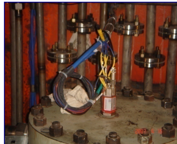
安装在现场的力士乐传统系统的油缸部分及控制管路
